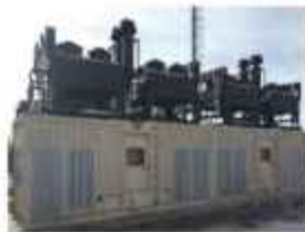
哈萨克斯坦某天然气电站项目 A natural gas power plant project in kazakhstan
