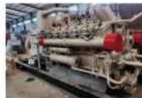
泰安污水处理厂项目 Tai'an sewage treatment plant
